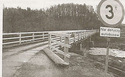
Zerwany most. We wrześniu po gwałtownym przyborze wód w Olszance naruszona została konstrukcja mostu, co groziło katastrofą budowlaną. Powiatowy Zarząd Dróg w Lesku wyłączył na czas nieokreślony most na Olszance, wstrzymując tym samym możliwość przejazdu drogą Uherce Mineralne – Bóbrka. Po remoncie mostu ruch został przywrócony.
