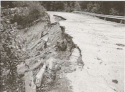
Droga zjechała. Po obfitych deszczach we wrześniu obsunął się korpus drogi pomiędzy Polaną a Czarną. Droga została zamknięta. Mieszkańcy Polany powinni jeździć do Czarnej przez Rajskie, Wolkowję, Polańczyk, Solinę, Uherce Mineralne i Ustrzyki D. Jeżdżą drogą leśną albo (też wymagającą pilnego remontu kapitalnego) drogą Polana-Skorodne-Lutowiska. Do kiedy to potwra? Nie wiadomo.
