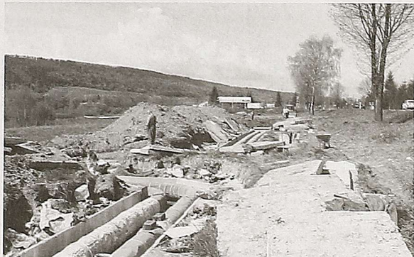
Po 30 latach eksploatacji przeprowadzany jest szczegółowy przegląd ciepłociągu Fot. T. Szewczyk
