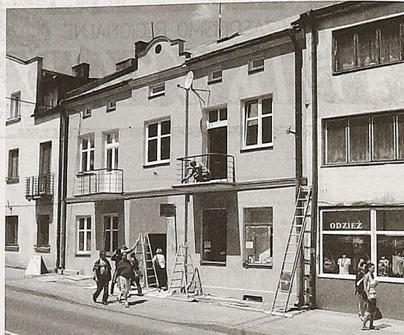
Remont budynku przy ul. 29 Listopada 3 powinien się wkrótce zakończyć Fot. T. Szewczyk
