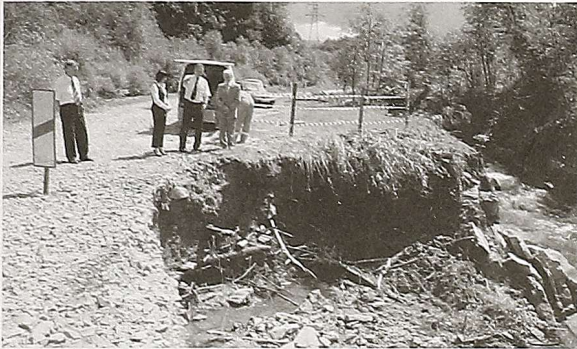
Wielka woda poważnie uszkodziła drogę powiatową pomiędzy Polaną a Lutowskami Fot. Z. Krasowski
