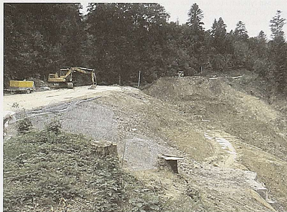
Kilka tygodni temu odbudowywano przepust. Teraz na finiszu jest budowa korpusu drogi Fot. T. Szewczyk
