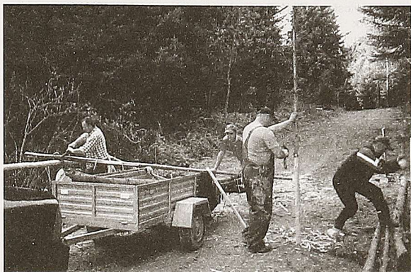
Prace modernizacyjne trwały kilka miesięcy (od lewej M. Podkalicki, K. Fundanicz, W. Fundanicz i M. Grzędziel) Fot. S. Nahajowski
