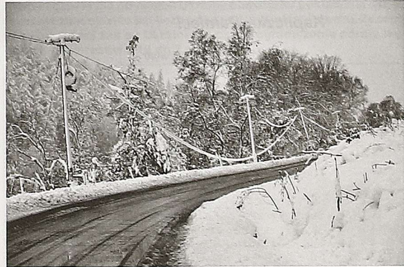
Przewody elektryczne i telekomunikacyjne nie mogły udźwignąć mokrego śniegu Fot. M. Szewczyk
