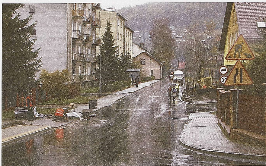
Modernizacja jezdni i chodników w ciągu ul. Korczaka kosztowała prawie 400 tys. zł
