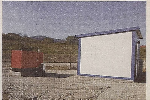
Dźwiniacz D. – przepompownia
