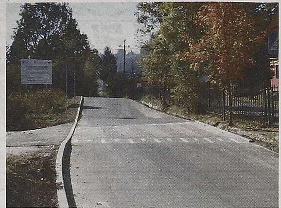
Do niedawna była to droga z nawierzchnią gruntowo-płytową Fot. T. Szewczyk
