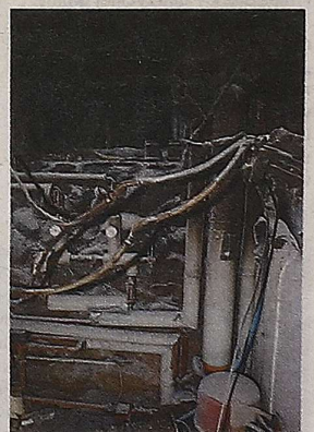
Zniszczone przez ogień pomieszczenie z podgrzewaczami wody
