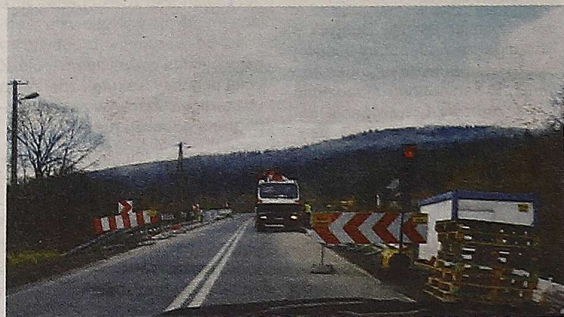
Remont mostu na potoku Łodynka powinien skończyć się w ciągu 2 miesięcy Fot. T. Szewczyk
