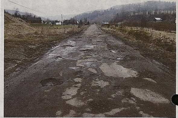
Ten odcinek drogi Krościenko-Stebnik został już wyremontowany przez powiat za pieniądze z „powodziówek”, ale dalsza jej część nadal tak wygląda Fot. T. Szewczyk
