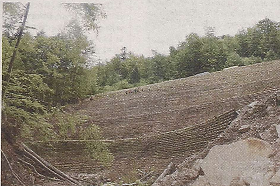
Ustabilizowane usuwisko nad potokiem Roztoki w Nadleśnictwie Stuposiany Fot. arch. RDLP w Krośnie
