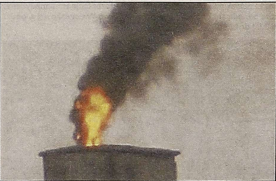
Zły stan przewodów kominowych bywa przyczyną pożarów
