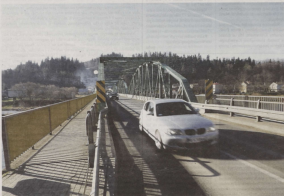
Most na Sanie ma być zamknięty dla dużych ciężarówek co najmniej przez dwa miesiące
