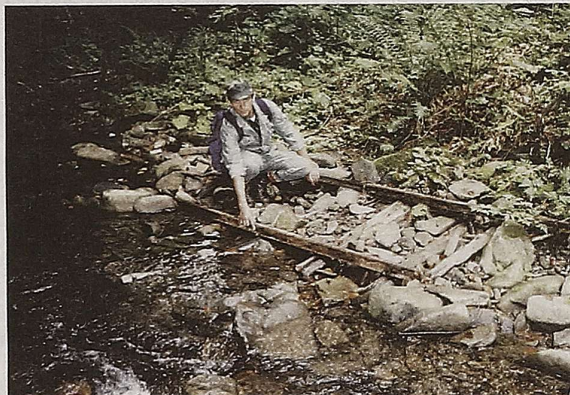
Rok 1993. Wypłukany przez potok fragment torowiska dawnej kolejki wąskotorowej
