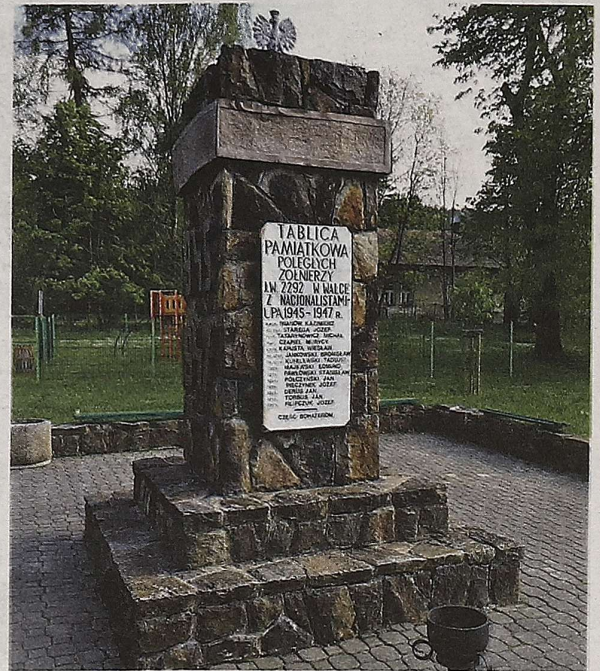
Pomnik z daleka nie wygląda źle, ale przy bliższym obejrzeniu widać, że wymaga drobnych napraw Fot. Krzysztof Potaczała
