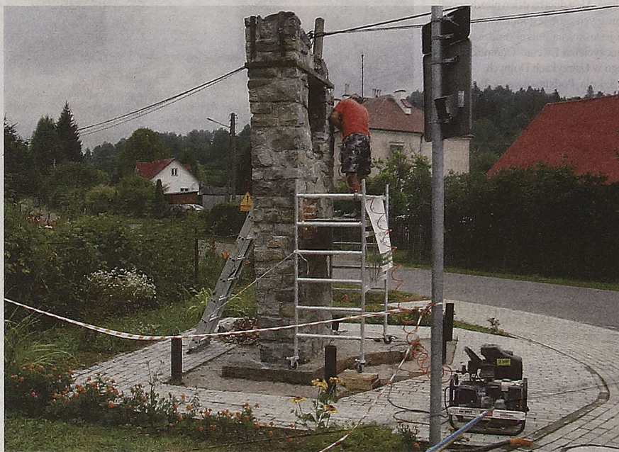
Ropienka, sierpień 2020 roku. Prace renowacyjne przy pomniku pomordowanych przez UPA w latach 1944-1947 Fot. Archiwum BCTIP w Ustrzykach Dolnych
