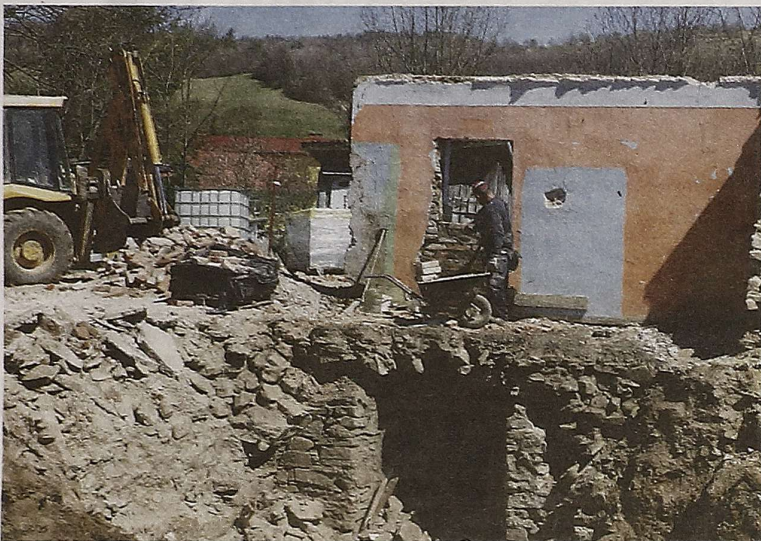
Roboty przy wyburzaniu jednej ze starych, zagrażających bezpieczeństwu lokatorów kamienic. FOT. LUKASZ BAIDA
